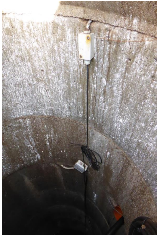
Samledåser i pumpebrønden: Øverst alarm (4,5 v), nederst spændingsforsyning til pumpen (220 v)
