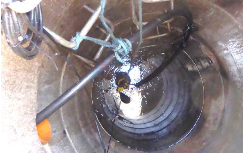
Pumpe med flyderkontakt, pumpe slang til afløbsbrønd og blå ophalertov.
